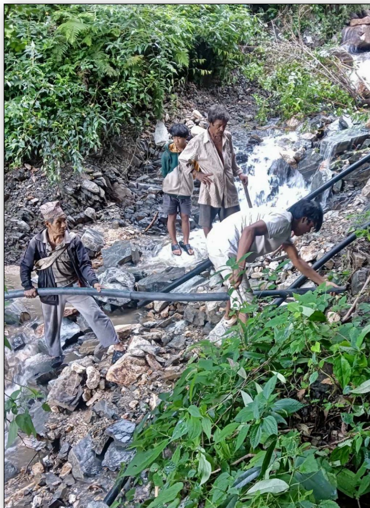
Tuyaux d'eau à réparer
