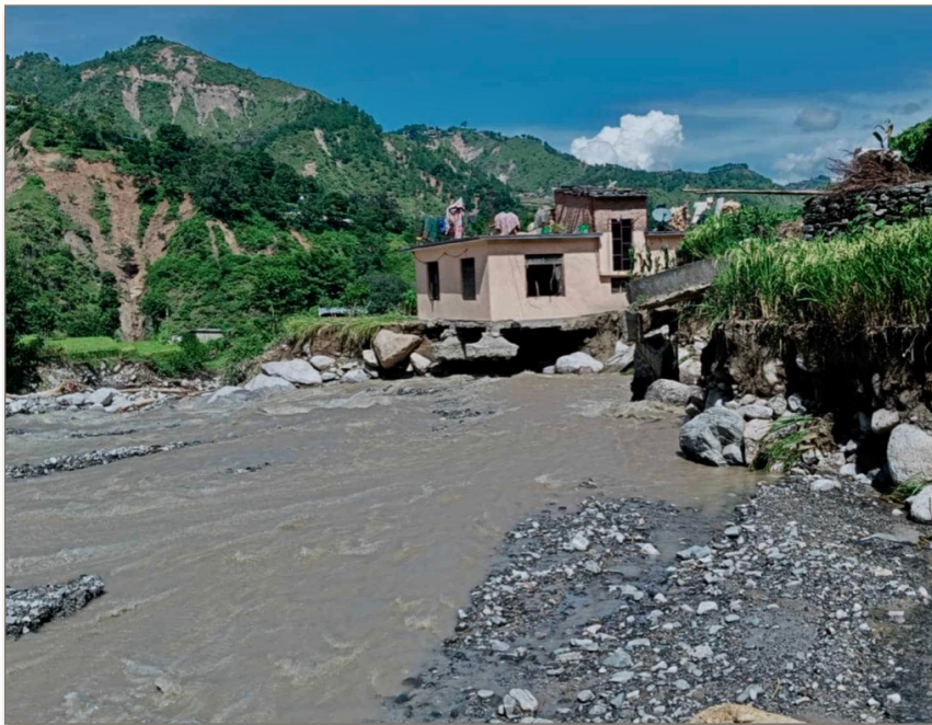
Inondations et glissements de terrain détruisent les routes et les maisons
