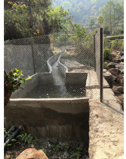
Le nouveau réservoir de captation
