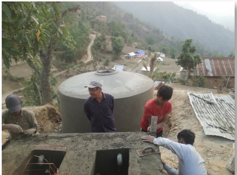
Réservoir de captation pour le village de Massarangue
