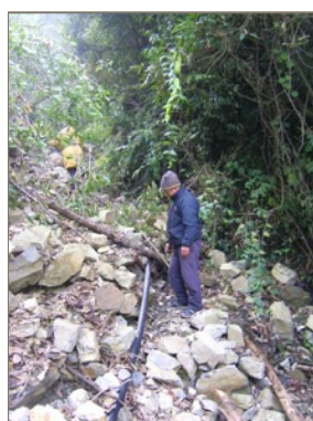
Éboulis dû à la construction d'une nouvelle route
